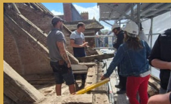
Sous un impressionnant échafaudage, la toiture est mise à nu pour un diagnostic et une remise à neuf.
